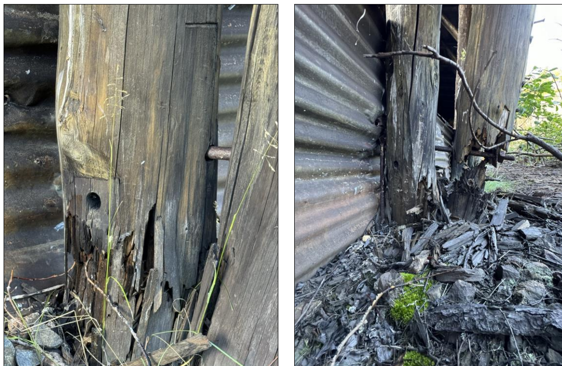
Figur 4.9 Bilder av bæresystem - søyer i svært dårlig tilstand. Kilde: Bane NOR/Tobias Ekhorn Jensen
