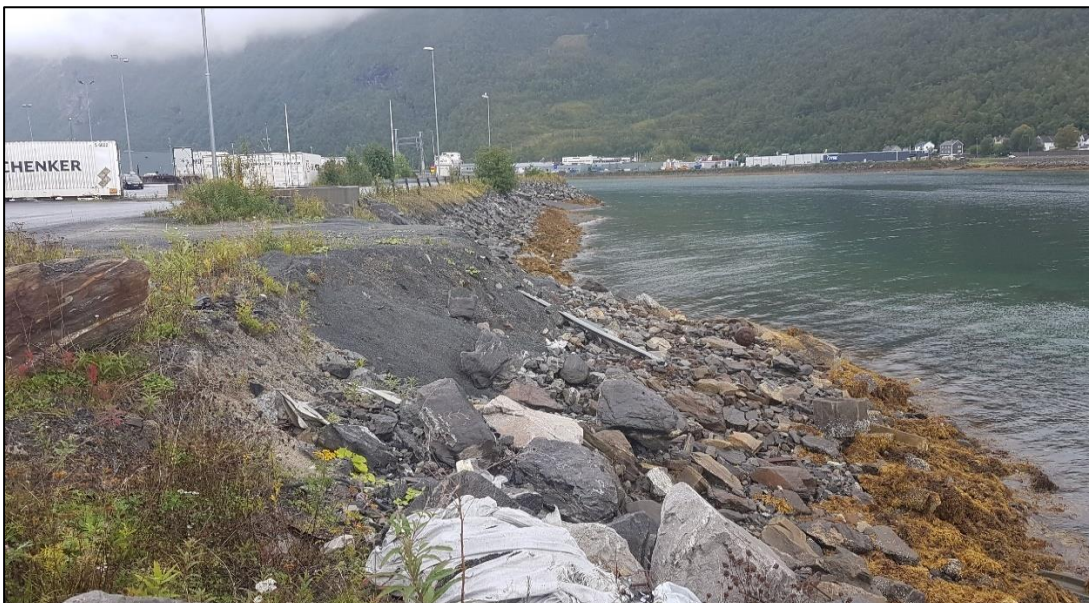
Figur 13: Utfyllinger mot Beisfjorden øst på Skarveneset. På denne strekningen har fyllingene en mindre god avslutning mot sjøen – både vedr. linjeføring og overflatebehandling (steinplastringer).
