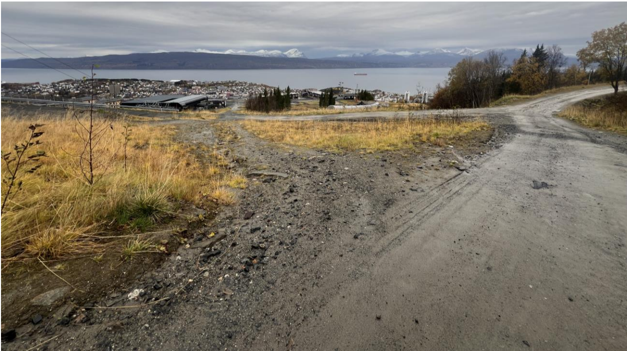
Bilde 5: Ovenfor Alpinhotellet har vannet tatt nye veier og tatt med seg noe løsmasser. Sett mot nord.
