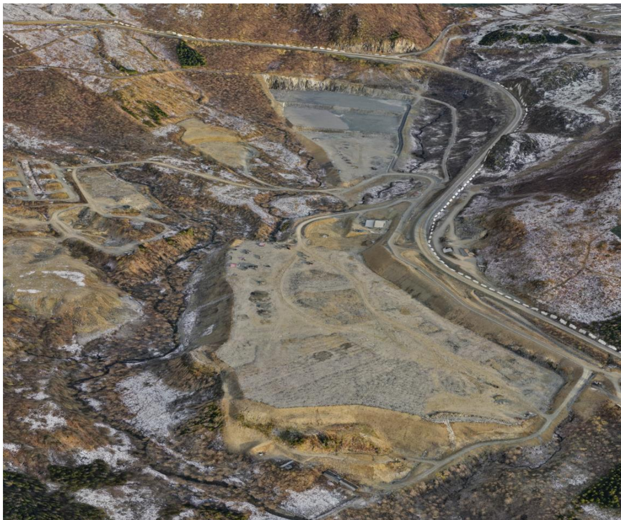
Figur 1-4: Flyfoto over Skoglund som viser gjennomførte grunnarbeider på områdene hvor det foreslås etablert ammoniakkanlegg, hydrogenanlegg og annen industri.
