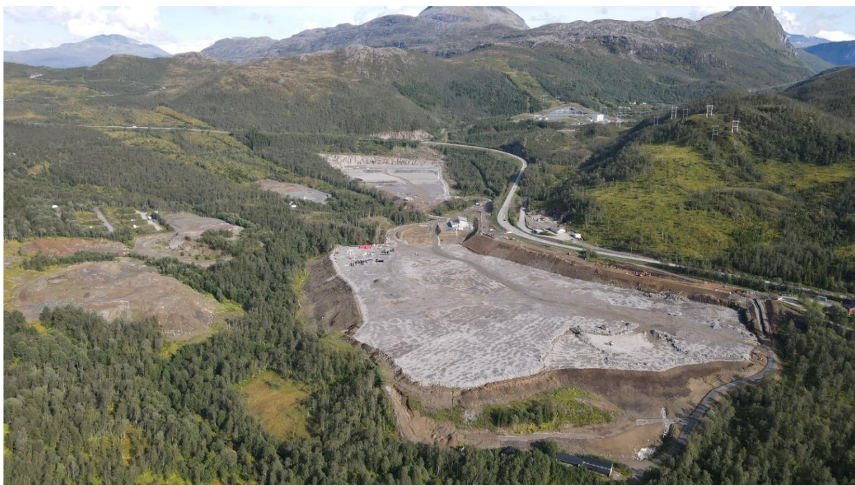
Figur 1-3: Skoglund – dagens situasjon. Dronefoto som viser gjennomførte anleggstekniske grunnarbeider. Foto: Aker Narvik.
